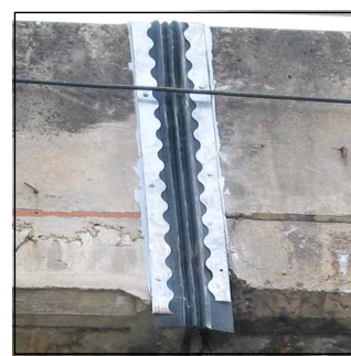
d. 설치 전경(외측)
